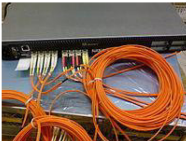
Рис..1 SAN-Свитч Qlogic SANbox 5600 с подключёнными к нему оптическими разъёмами Fibre Channel
